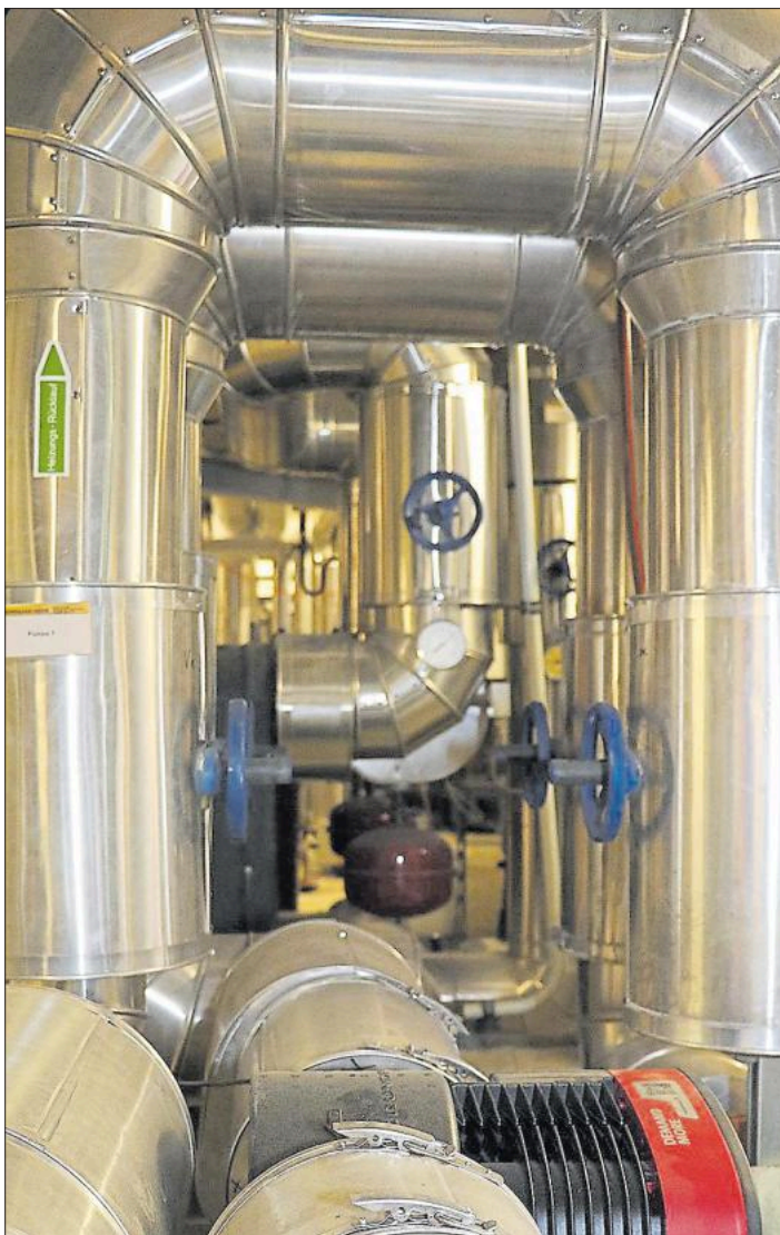
Herzstück der Fernwärmeleitung: Im Technik-Keller des Freizeitbads Brunsbüttel kommt die Energie der Sasol an.
